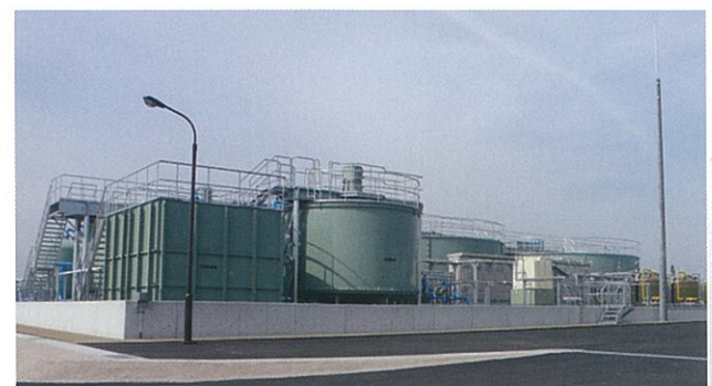
余水処理施設
